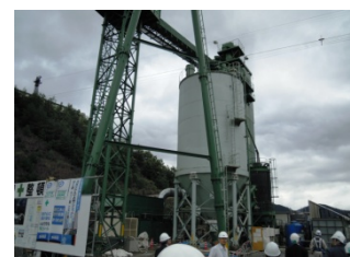
写真-2 コンクリート製造設備
