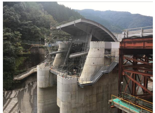
【山須原ダム洪水吐きゲート】
