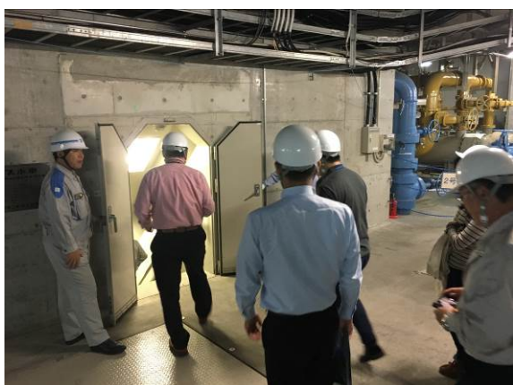
【小丸川発電所発電機見学】
