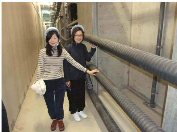
【小丸川発電所6万ボルト電線】
